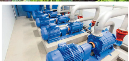
BOMBEIGS I FILTRATGES
